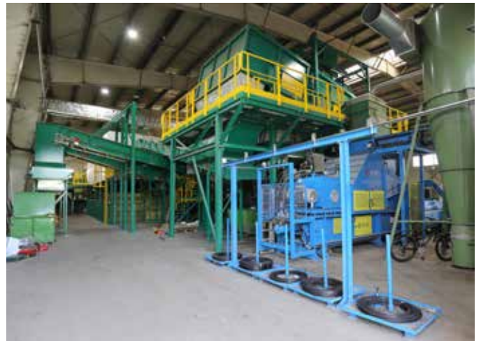
Separator balistyczny jest umieszczony nad przenośnikami taśmowymi i częściowo prasą kanałową. Takie usytuowanie maszyny pozwoliło zaoszczędzić miejsce w hali, ale było nie lada wyzwaniem, m.in. ze względu na niewielką odległość do dachu.
