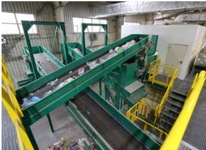
Głównymi materiałami otrzymywanymi na wyjściu separatora balistycznego jest frakcja 2D (na zdjęciu) oraz 3D. Wstępna segregacja ułatwia dalsze sortowanie, co przekłada się na możliwość wydzielenia dodatkowych rodzajów surowców wtórnych.
